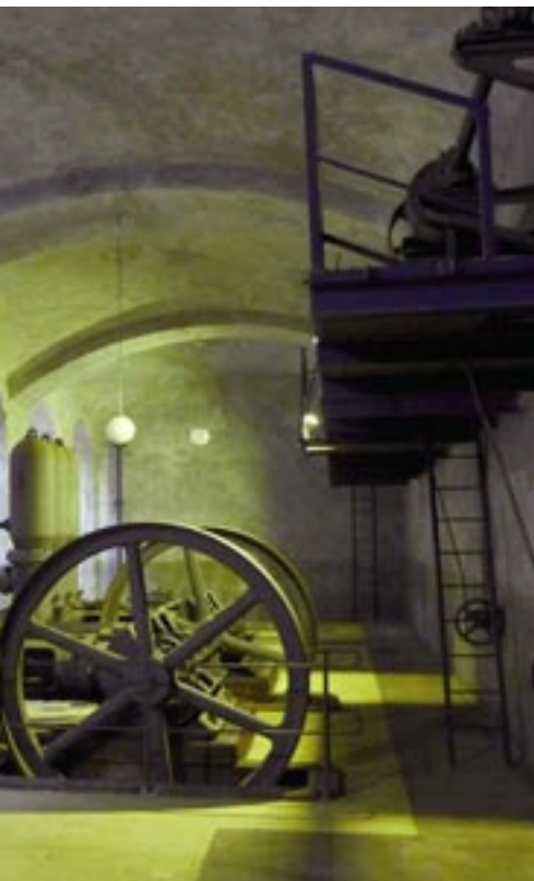
Kalová čerpadla byla poháněna z transmise, původně napojené na dvojici parních strojů, nalézající se v protilehlé části budovy. Později byla tato část transmise oddělena a napojena na elektromotor, umístěný v hale nad lapačem písku.
